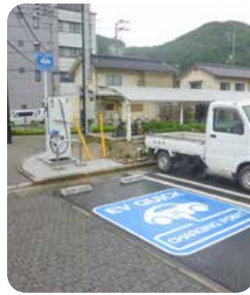
設置した急速充電器
