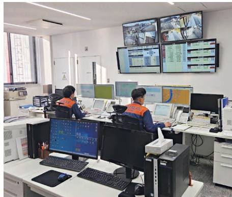
新消防庁舎の通信司令室の様子
