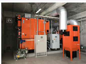
木質バイオマスボイラー
