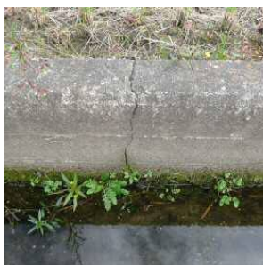
縦方向のひび割れ
