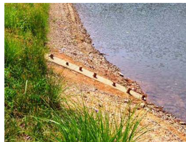
老朽化した取水施設
