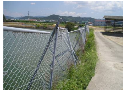
ため池における 破損した金網フェンス
