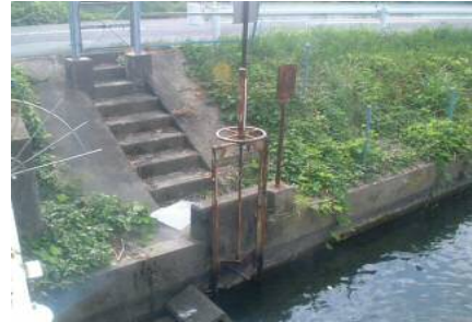
老朽化したゲート
