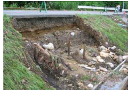
道路法面の崩壊
