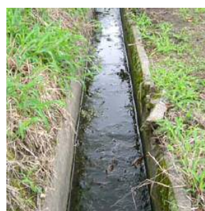
部分的な欠損
