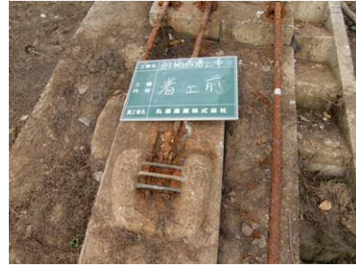
ため池における 老朽化したゲート
