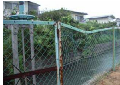
破損した金網フェンス
