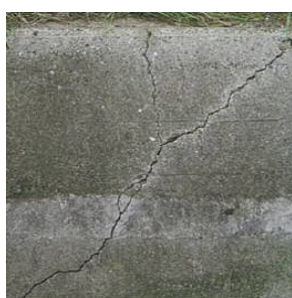
斜め方向のひび割れ
