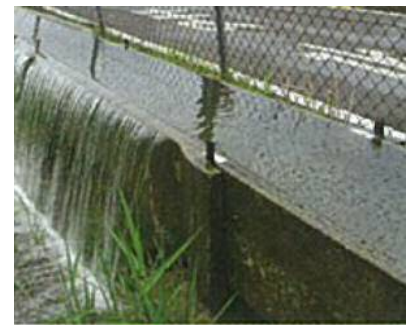
水路からの溢水
