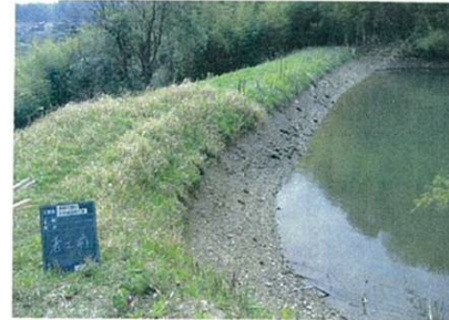
漏水が生じているため池
