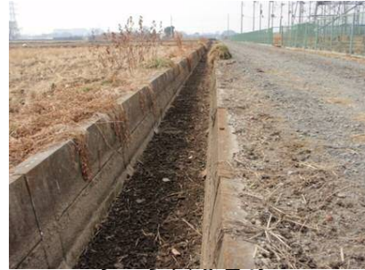
安全施設がない水路
