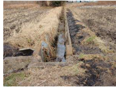
老朽化した水路（全景）
