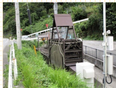
農業用水路の小水力発電設備
