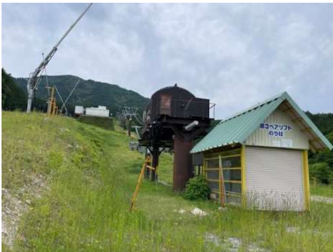
第3ペアリフト 写真方向 ⑧（北→南）
