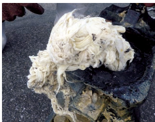
詰まったトイレ掃除用シート
