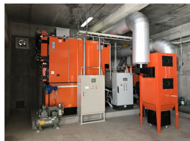
木質バイオマスボイラー (いぶきの里)
