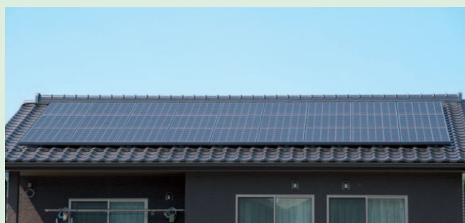
太陽電池パネル
