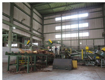
木質チップ製造設備
