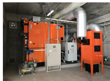
木質バイオマスバイラー (新見千屋温泉いぶきの里)
