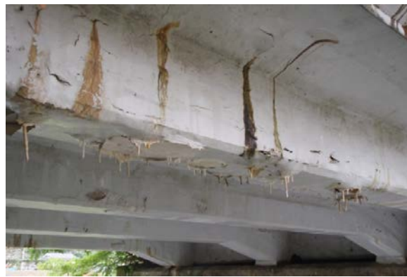
主桁 塗装剥離・ひび割れ
