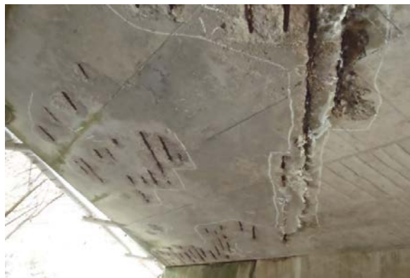
床版 鉄筋露出
