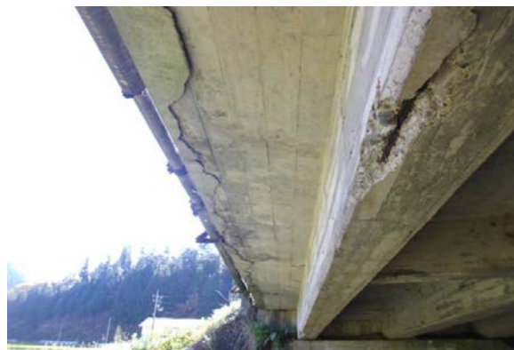
主桁 鉄筋露出
